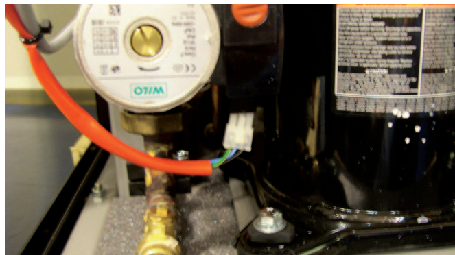
B. Montering av 3-poligt don i VP-pump
