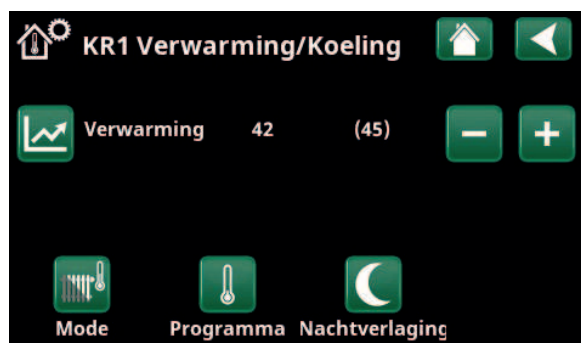
Menu "Installateur/Definieer/Verwarmingskring/Verwarmingskring 1". Het verwarmingskring heeft geen ruimtevoeler. Het setpoint (vertrektemperatuur 45 °C) staat tussen haakjes, de huidige vertrektemperatuur 42 °C staat links van het setpoint.
